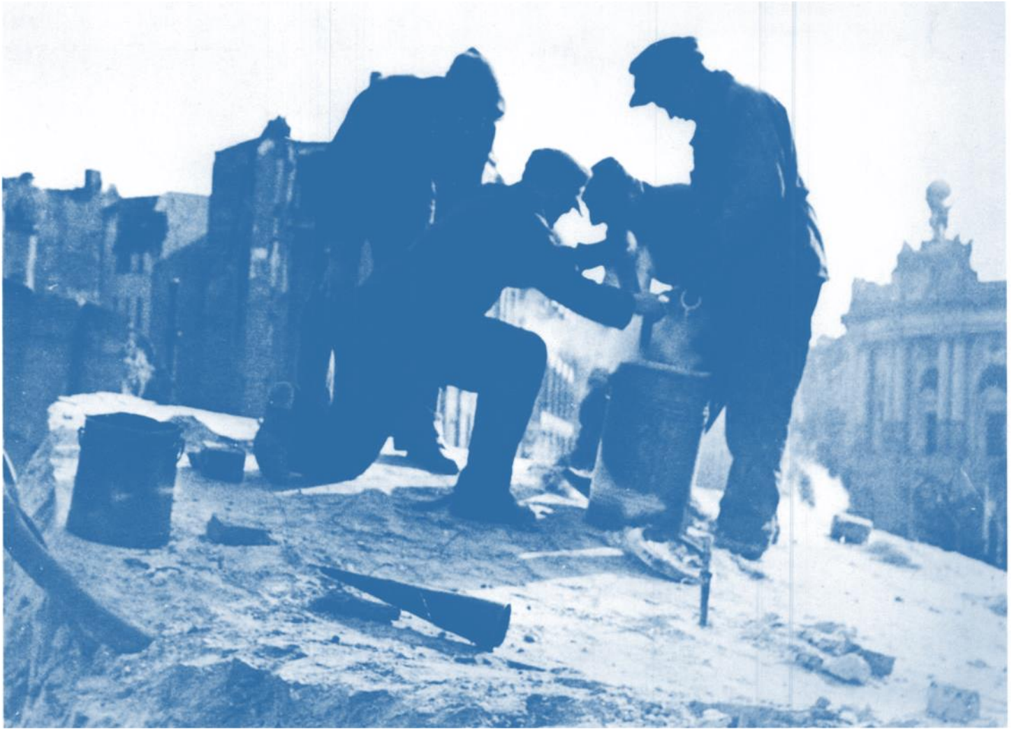
Abriss- und Räumarbeiten in der Leipziger Strasse: Die Sprengladung wird in die Bohrlöcher eingefüllt, 1947.
