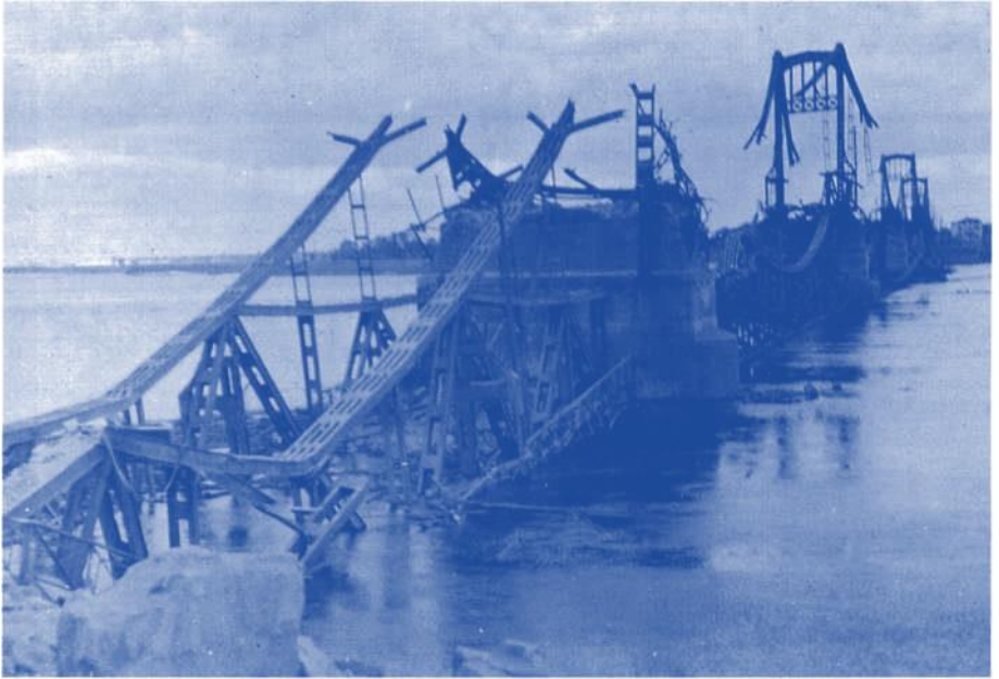
21 Fritz Probst, Baubataillon: eine zerstörte Dnjepr-Brücke in Kiew, 1941.
