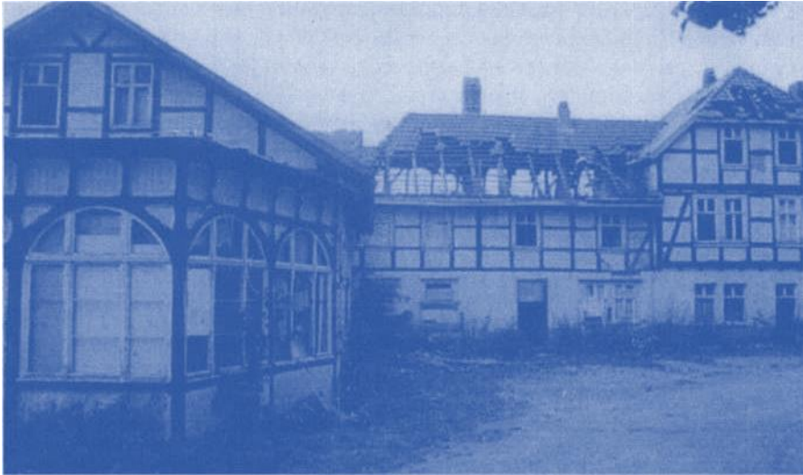
Gaststätte «Landhaus». Die Schäden im Dach des 1933 fotografierten Gebäudes stammen von einem Brand.
