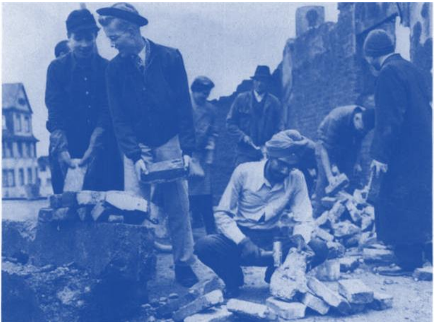
59 Internationale Bauhilfe für Flüchtlinge Anfang der fünfziger Jahre. Quäker aus Indien, Amerika, England und Ungarn helfen beim Aufbau eines zerstörten Hauses.
