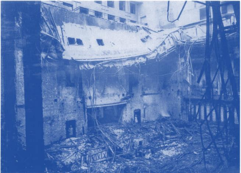
Eingestürzte Zwischendecke im Plenarsaal.
