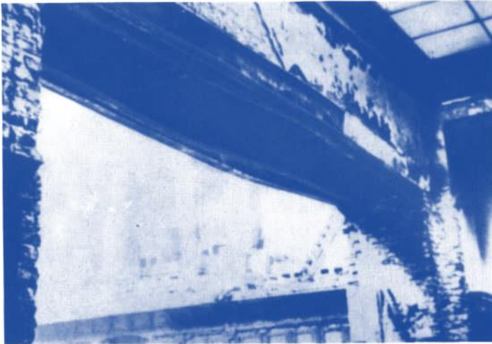
Folgen der Explosion und des «Flammenmeeres»: verbogene Stahlträger.
