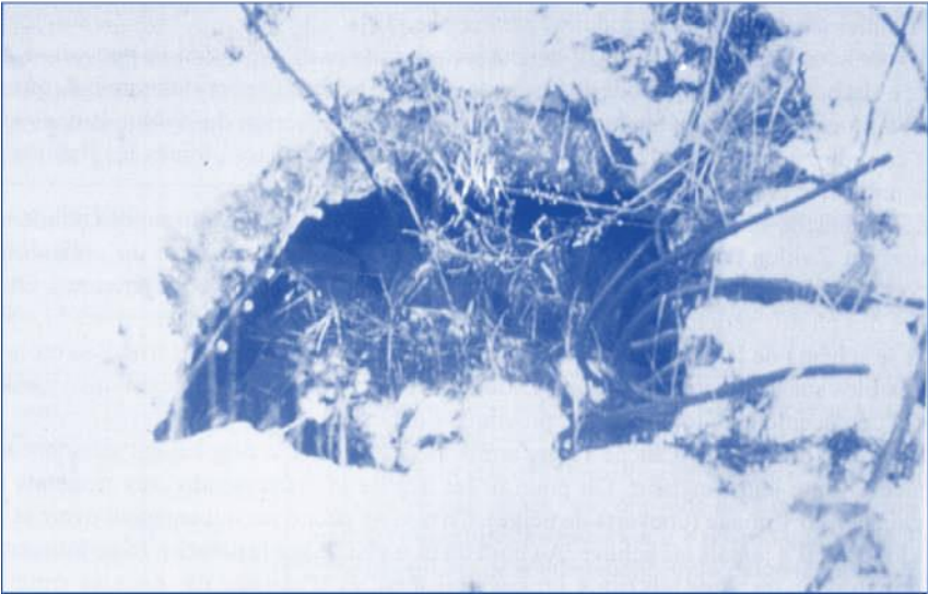
Abbildung 52: Angebliches Zyklon B-Einwurfloch in der Decke des Leichenkellers 1 («Gaskammer») vom Krematorium II. Es ist deutlich sichtbar, dass es nicht von den Bewehrungsseisen des Stahlbetons befreit wurde. Diese wurden einfach nach hinten umgebogen.
