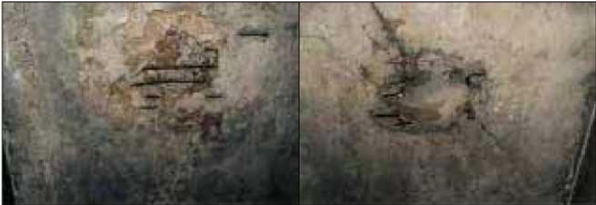
Abbildungen 24 und 25: Zerfallserscheinungen, sichtbar an der Innendecke des Leichenkellers des Krematorium I im Auschwitz-Stammlager: Nach über 50 Jahren fangen die nahe der Oberfläche liegenden Eisenbewehrung an zu rosten und sprengen den Beton auf. Die provisorischen Versuche der Museumsleitung, diese Löcher zu verputzen (rechts), sind zum Scheitern verurteilt.
