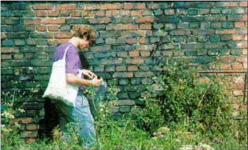
Abbildung 67: Im Gegensatz zum Bauwerk BW 5a (siehe Abbildung 64) wurde der Entwesungstrakt des Bauwerkes BW 5b länger als Blausäure-Entwesungskammer benutzt. Dementsprechend ist dessen Aussenmauer über grosse Flächen blau gefärbt, auch hier unbeeindruckt von 50 Jahren Witterungseinflüssen.
