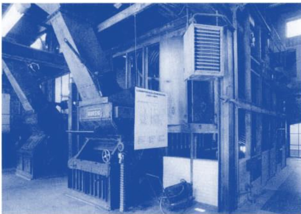
Die Spezial-Heizkessel der Neuen Reichskanzlei werden 1947/48 demontiert und im Krankenhaus Herzberge, in Berlin-Lichtenberg wieder aufgestellt. Aufnahme von 2002.
