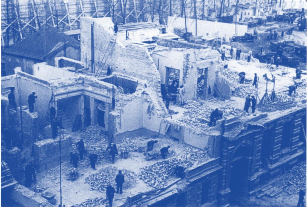
Im Vordergrund Abrissarbeiten für die Neue Reichskanzlei an den Gebäuden der Vossstrasse 11 und 12; im Hintergrund die hohe hölzerne Bauwand, die den Gartenbereich der Alten Reichskanzlei vor Lärm und neugierigen Blicken schützen sollte.
