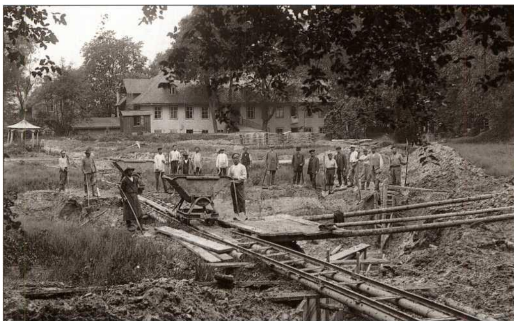
Zur ausreichenden Versorgung der Stadt mit Quellwasser wurden im Kriegsjahr 1916 unter Anleitung des Ingenieurs Karl Petri aus Strassburg Arbeiten an einem Rohrgraben des Römersbaches ausgeführt. Bei solch' umfangreichen Erdarbeiten wurden zu dieser Zeit meistens von Hand geschobene Kipploren benutzt. Das Gebäude im Hintergrund ist die Messerschmiede von Hugo Heinz.
