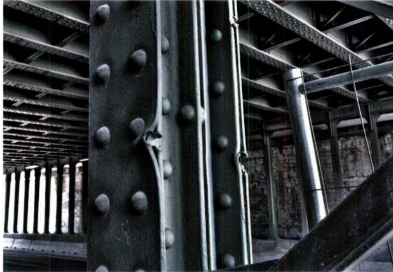
Am Pfeiler der Eisenbahnbrücke Kliebergasse/Landgutgasse: Durchschüsse im Stahl zeugen von heftigen Kampfhandlungen.
