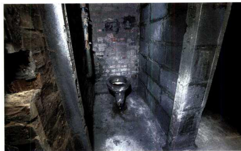
Die Tür fehlt bereits: ein Abort.
